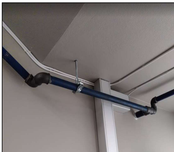
Brukte sprinkelrør, ferdig montert. Foto: Anne S Nordby
